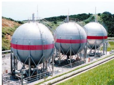
液化水素貯蔵タンク
